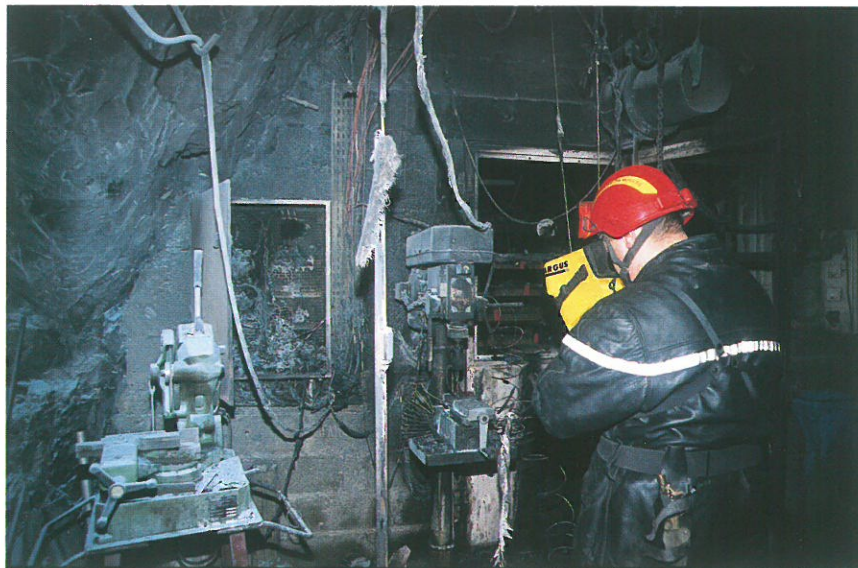
Vue de l'atelier sinistré, dans la galerie
